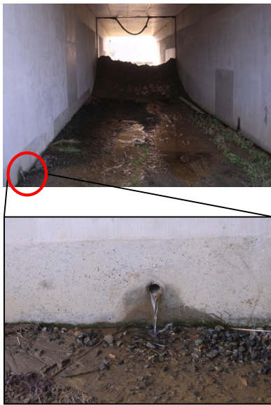
写真1 新潟県中越地震で被災した粘性土地盤上の高速道路盛土のボックスカルバートの様子 (地震発生：2004/10/23、写真撮影：2004/11/5)
